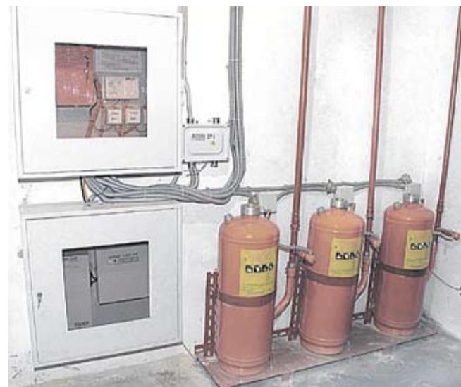
Блок управления системой пожаротушения
